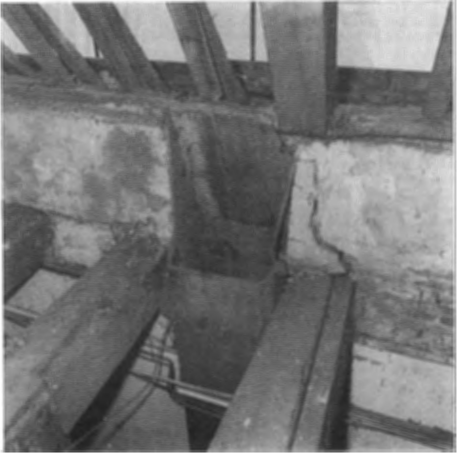
Invoeropening van de stortkoker op zolder tijdens de restauratie; de vloerplanken zijn verwijderd.
